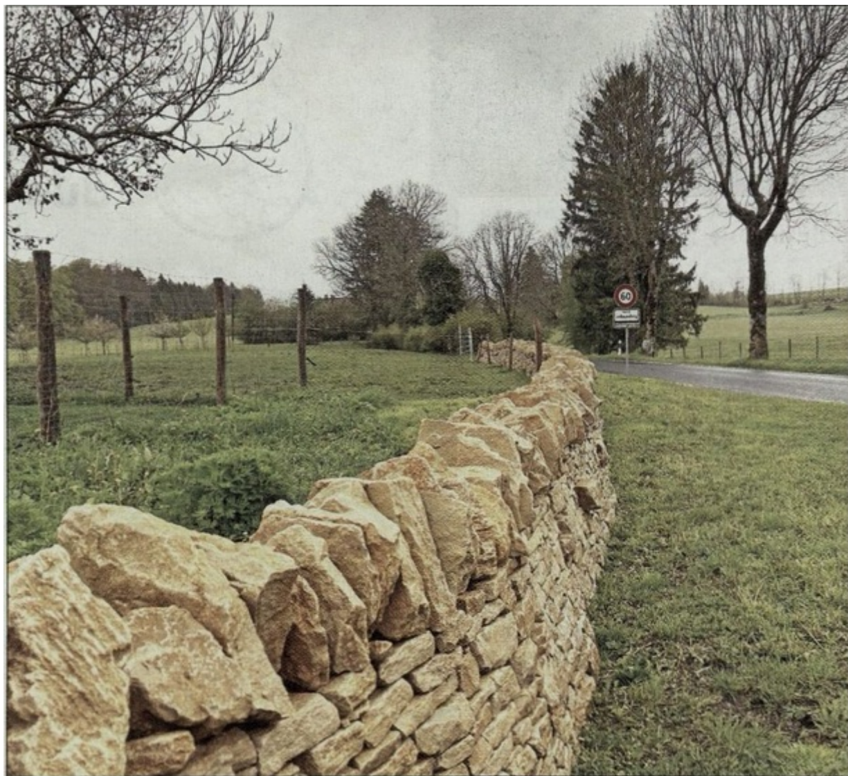
Dans le bilan 2020-2024 du Parc du Doubs, il a été fait entre autres mention des 250 m de murs en pierres sèches restaurés, comme ici aux Enfers. pmoknvs
