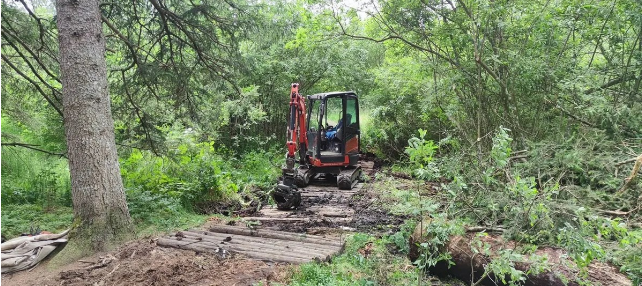
Am Etang de la Gruère werden aktuell dringende Arbeiten zur Sicherung von 42 Metern Steg durchgeführt. Foto: zvg/ Parc du Doubs
