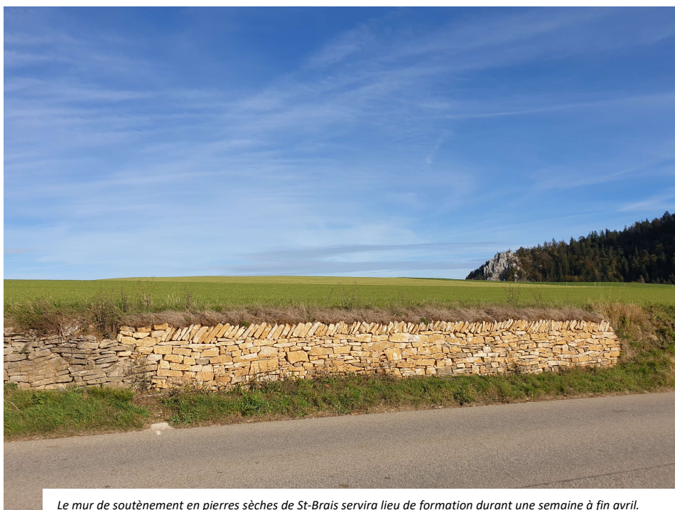
Le mur de soutènement en pierres sèches de St-Brais servira lieu de formation durant une semaine à fin avril.
